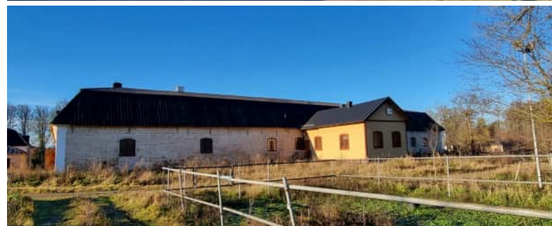
Södra fasaden (övre bilden) och östra fasaden (nedre bilden) innan åtgärd.
